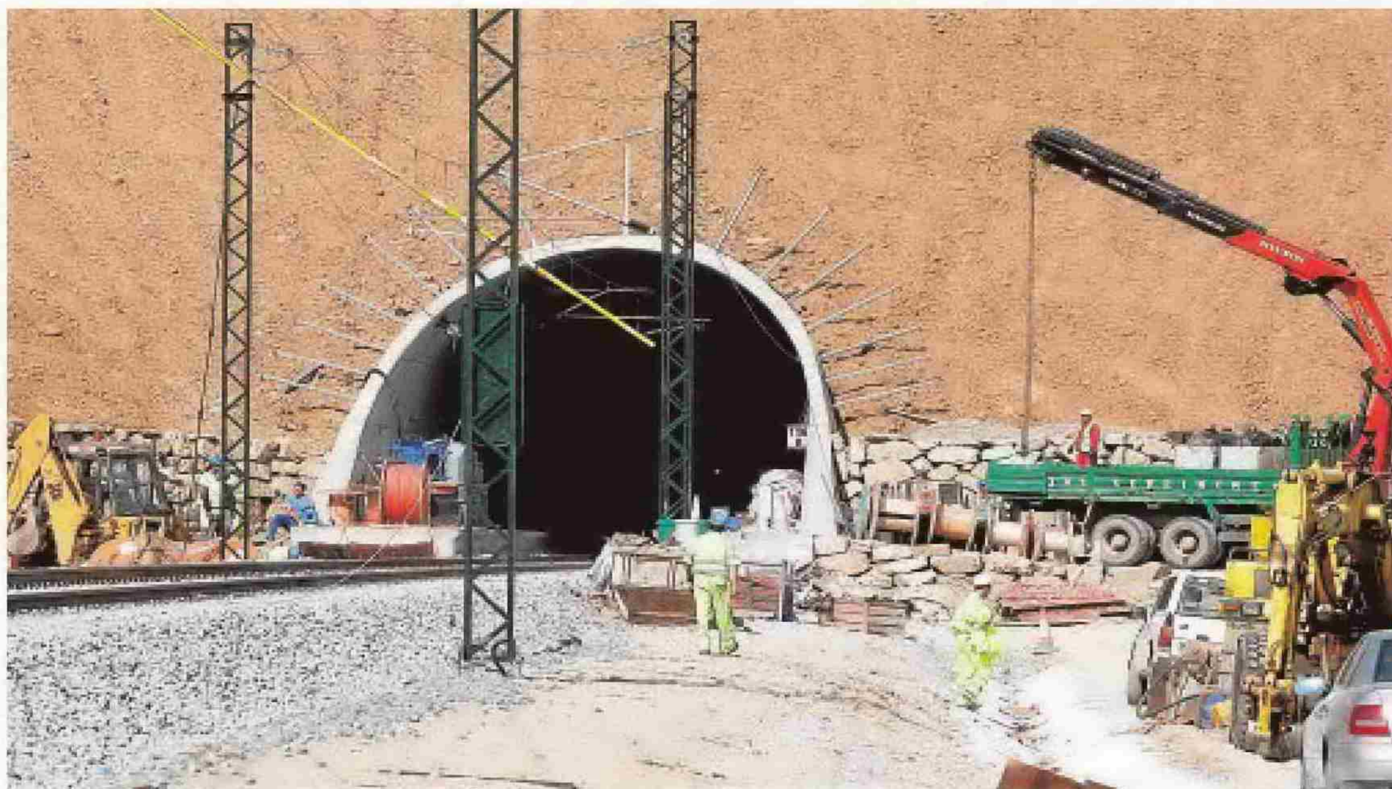
El túnel del AVE que pasa por el pueblo quebró la bolsa de agua que abastecía a los vecinos
