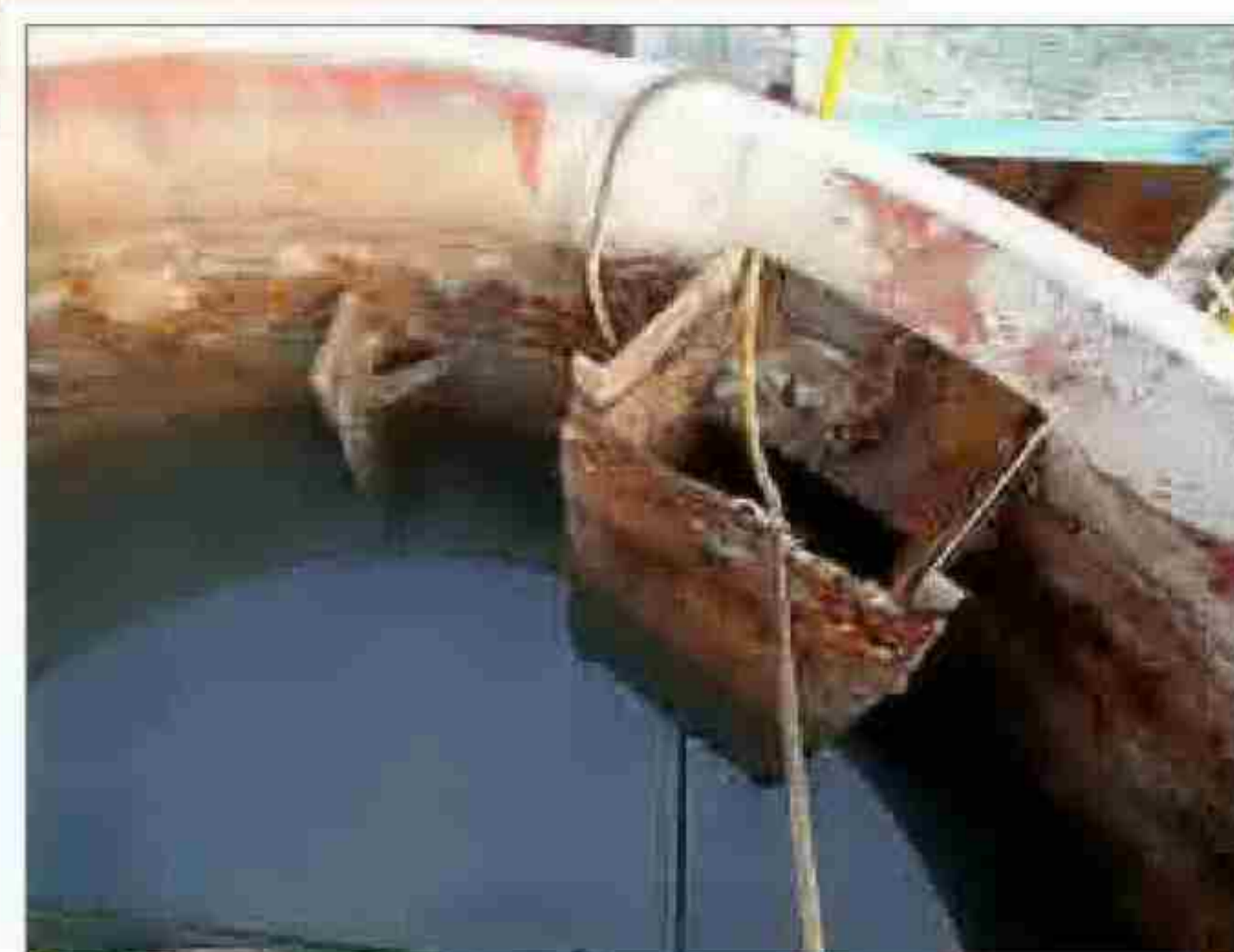
Efectos del abandono en otro punto de la depuradora. E.M.
