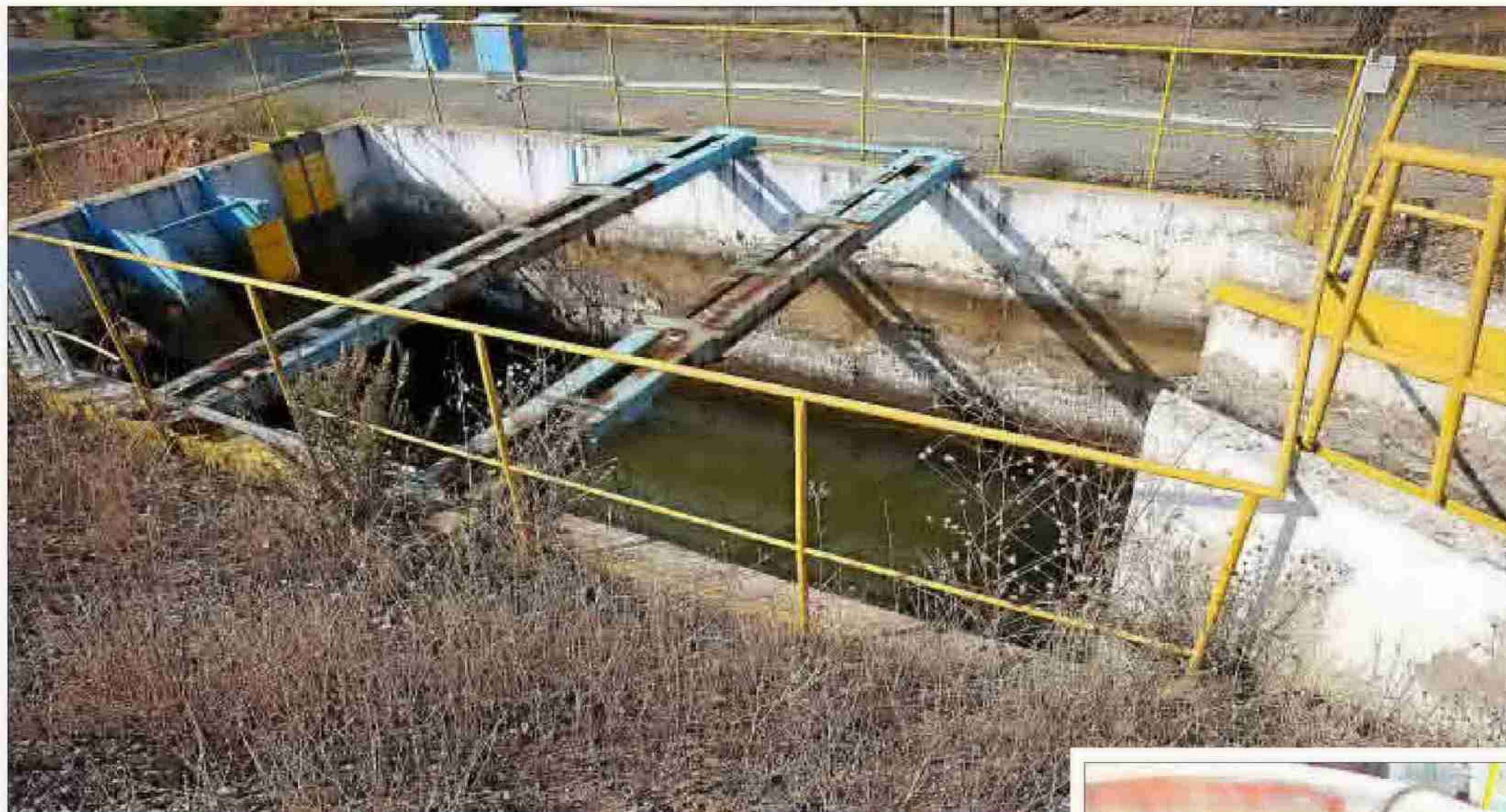
La maleza rodea las instalaciones de la depuradora de Aznalcóllar, afectadas por el óxido. EL MUNDO
