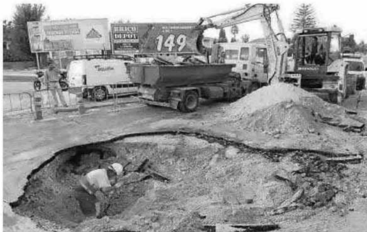
El asfalto cedió y causó un aparatoso socavón.
