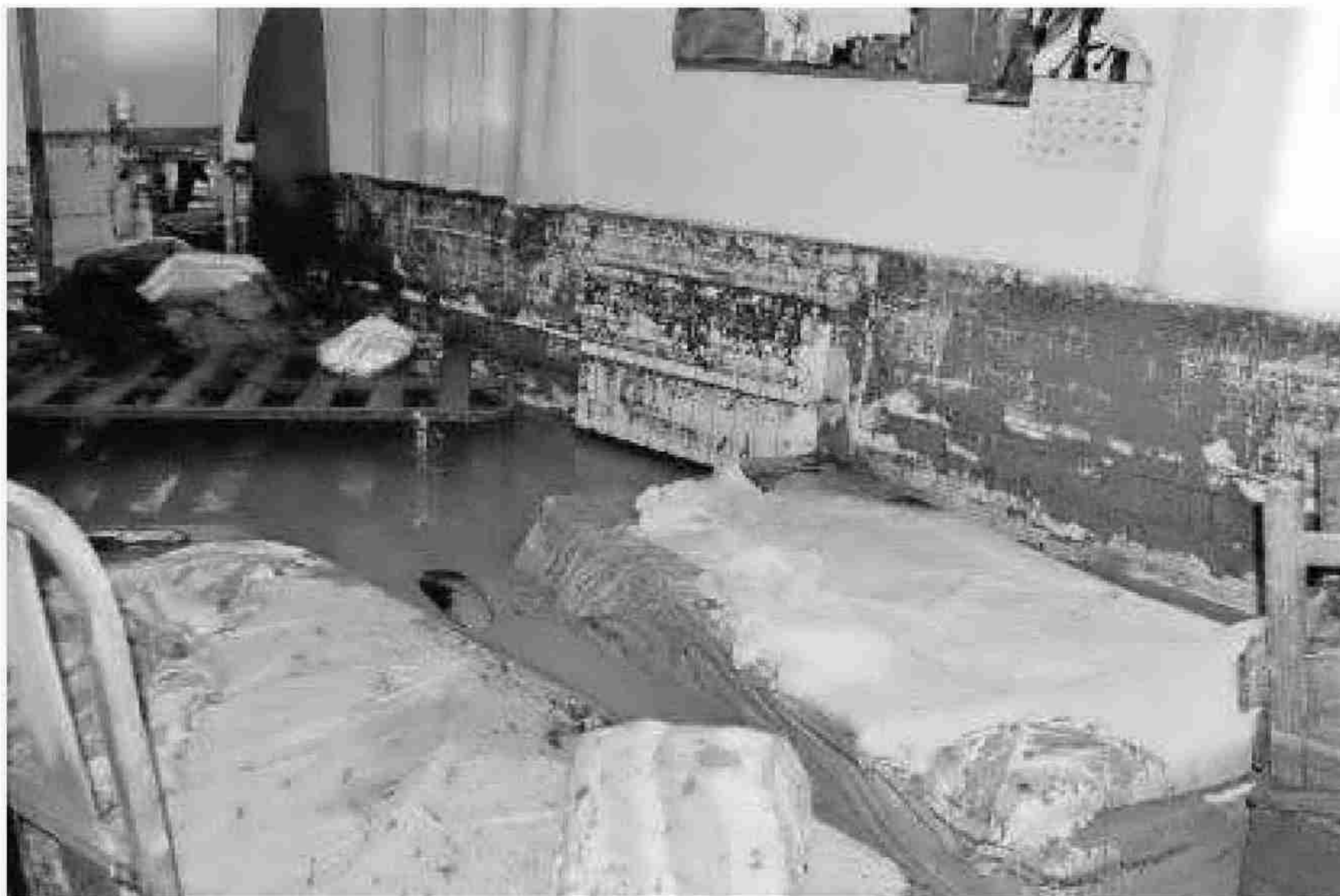
El interior del inmueble, totalmente destruido.
