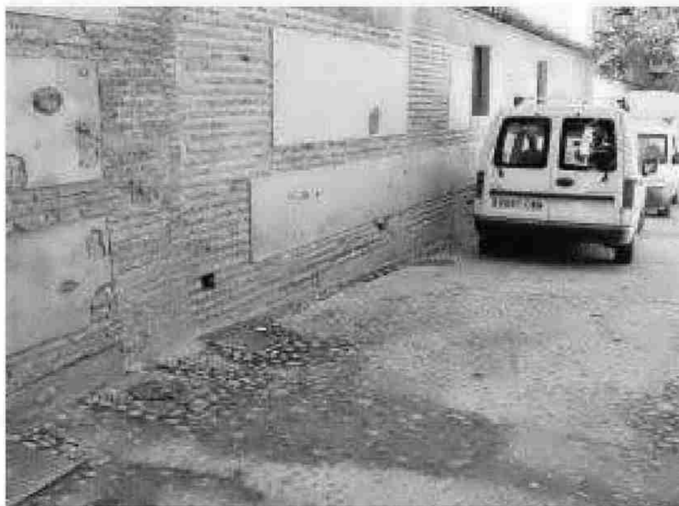
Imagen de los restos del charco que provocó la avería.
