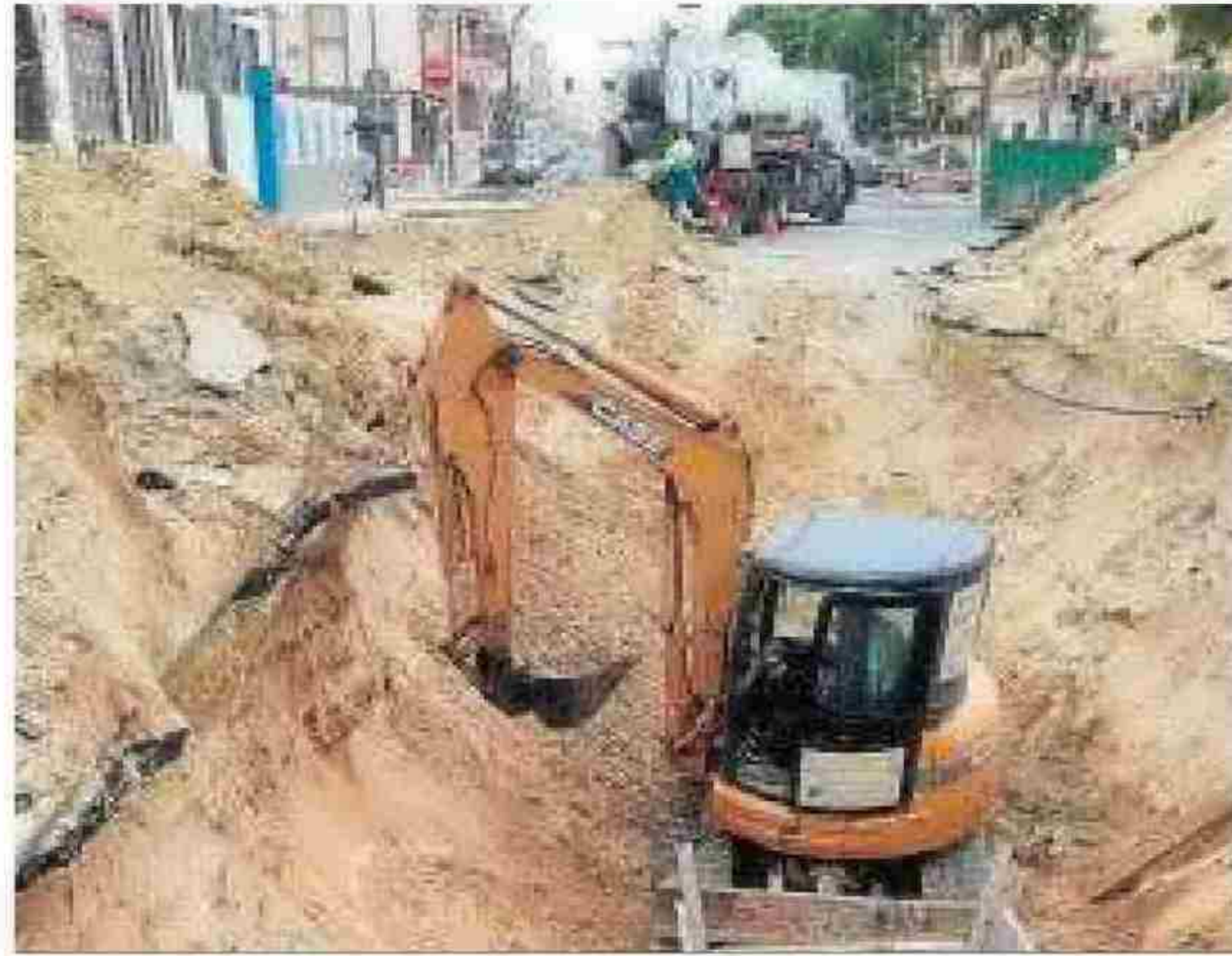
La reparación mantiene cortada al tráfico parte de la Avenida de las Piletas.
