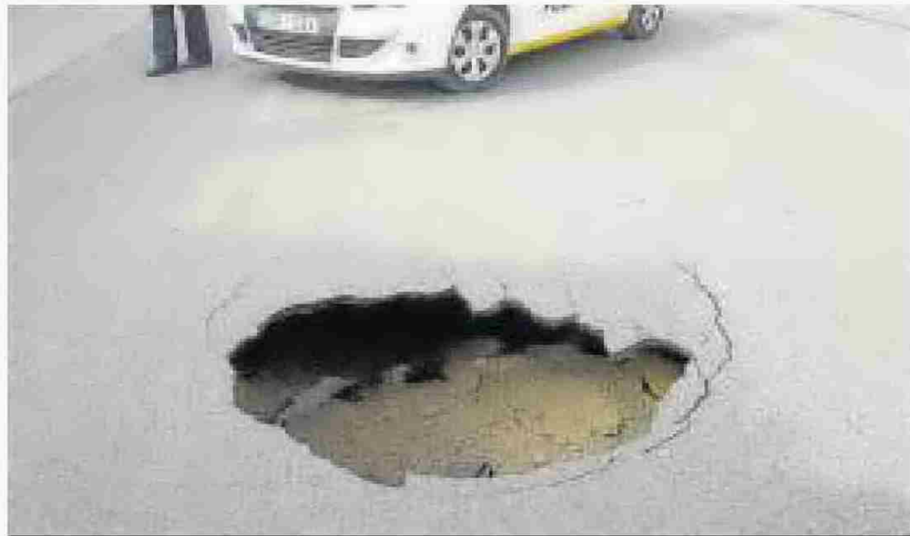
El hundimiento de la calzada en la Avenida de las Piletas.
