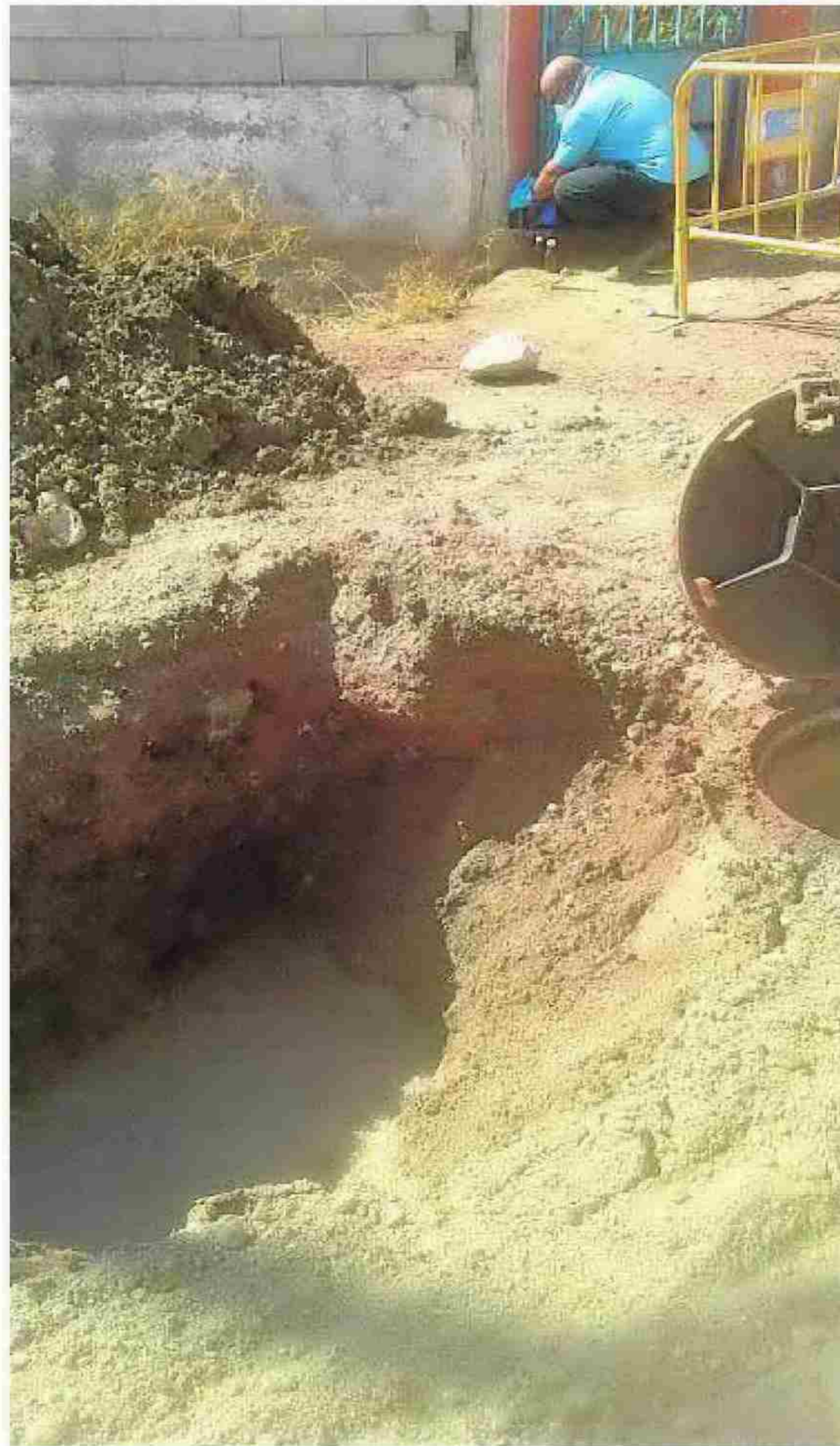
Zanja en la que se descubrió el vertido de agua ácida. :: A. M.
