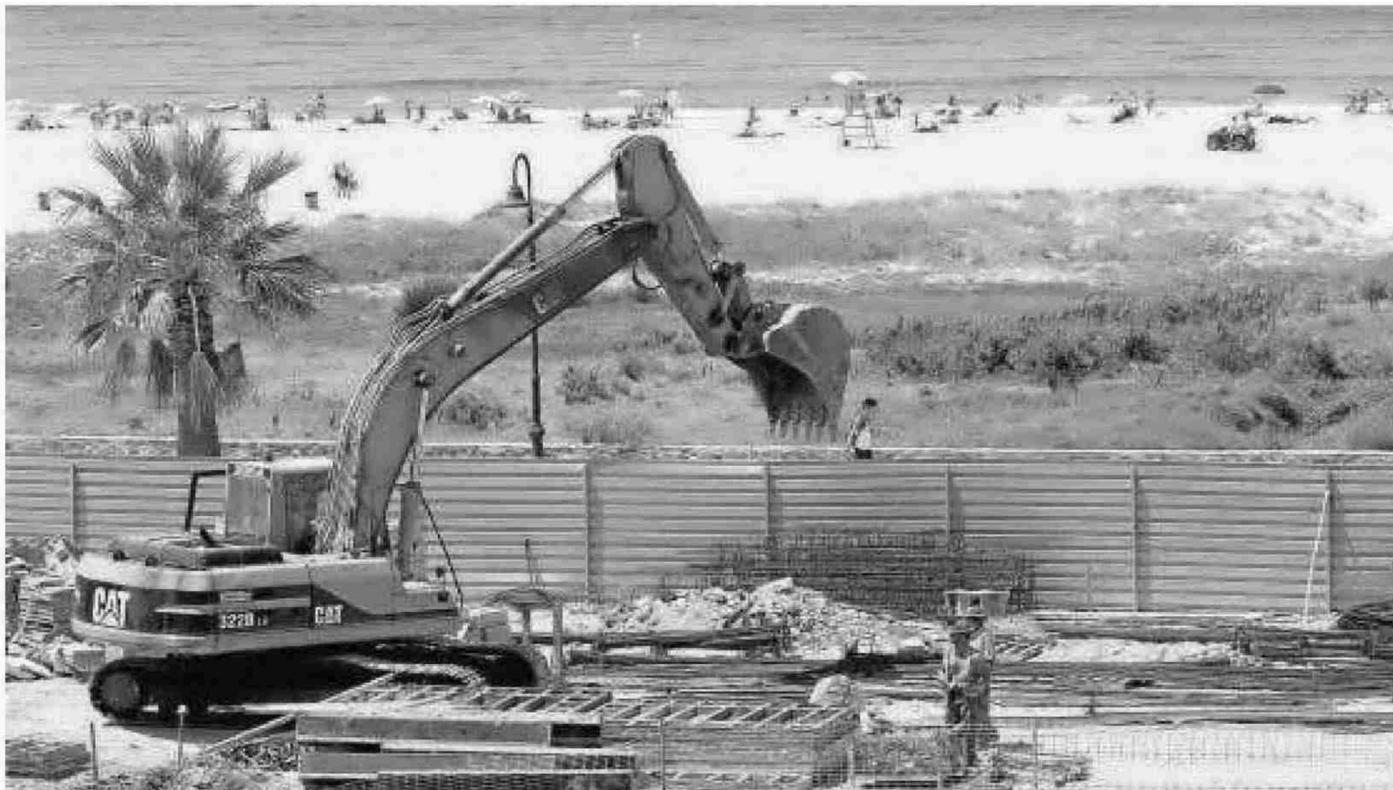
Vista general de las obras de la estación de bombeo de aguas residuales y, al fondo, la playa de Los Lances, en Tarifa, hace unos días.
