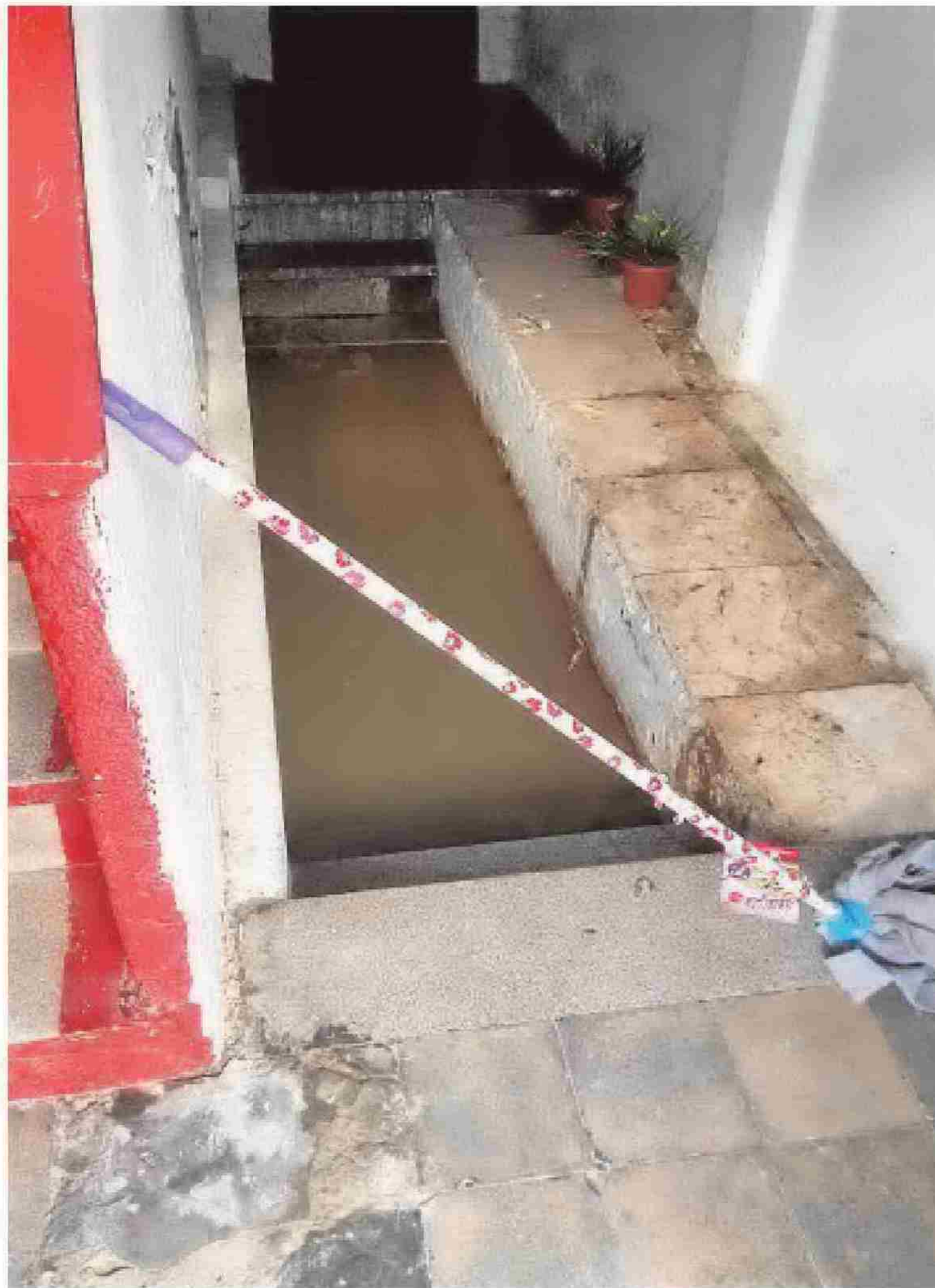
Portal de Los Pajaritos inundado de aguas fecales
