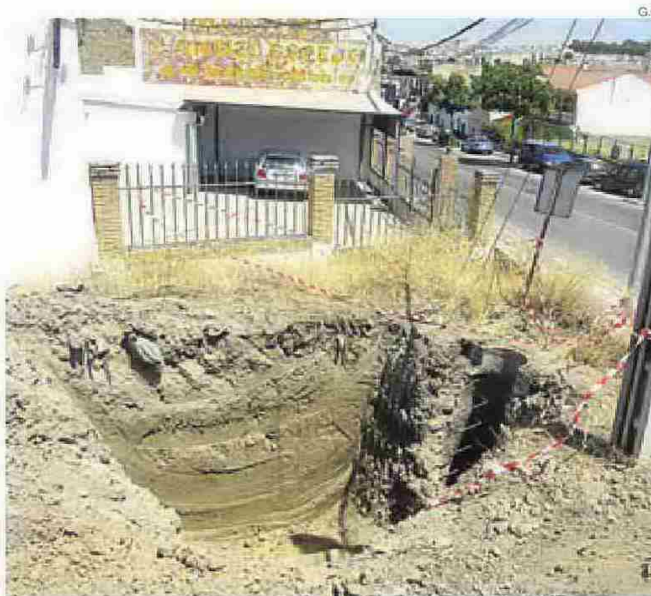
►► Rotura de una conducción de agua.
