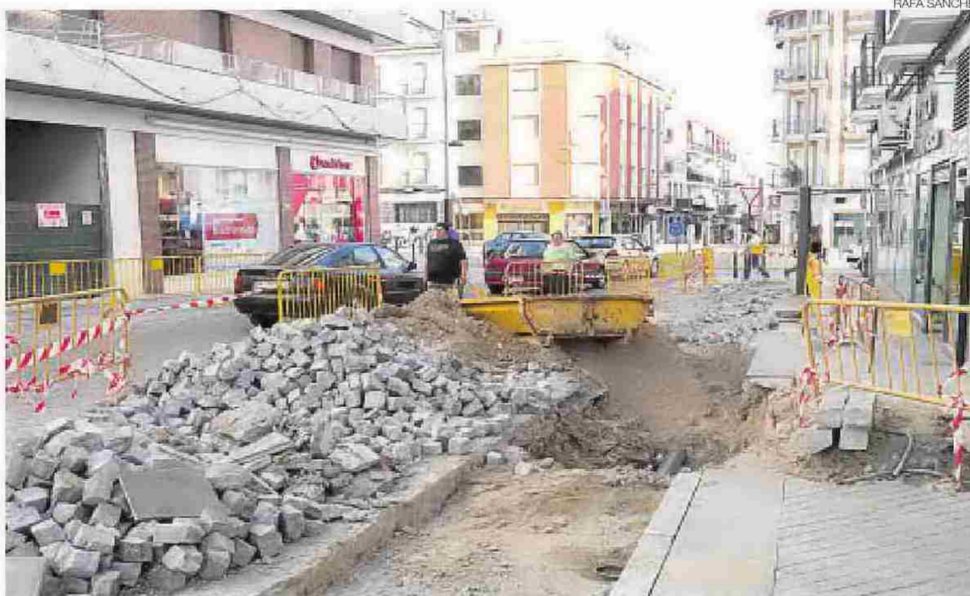
►► Rotura al inicio del paseo Marcos Redondo, en la confluencia con avenida Villanueva de Córdoba.
