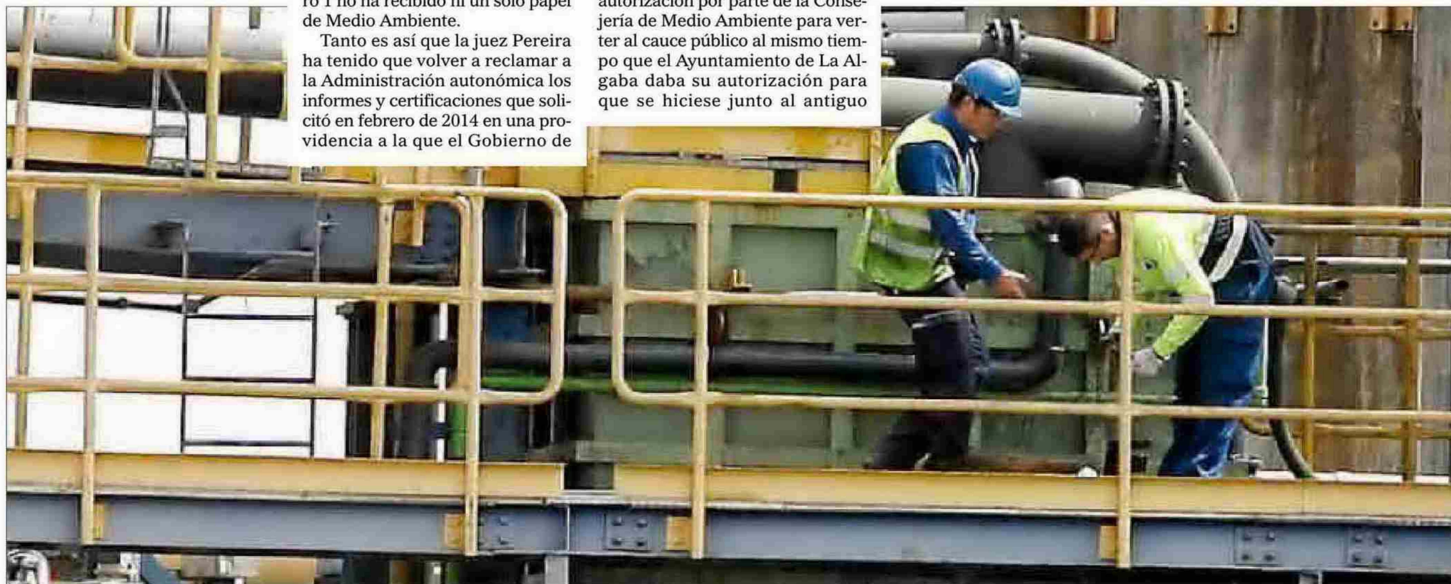
Dos operarios de Mina Las Cruces trabajan en las instalaciones principales de la compañía minera que explota el yacimiento a cielo abierto más grande de Europa. ESTHER LOBATO
