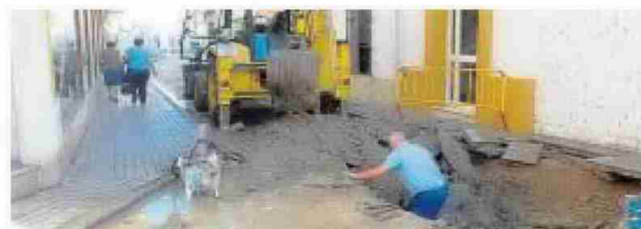
Socavón en el punto donde se produjo el escape.
