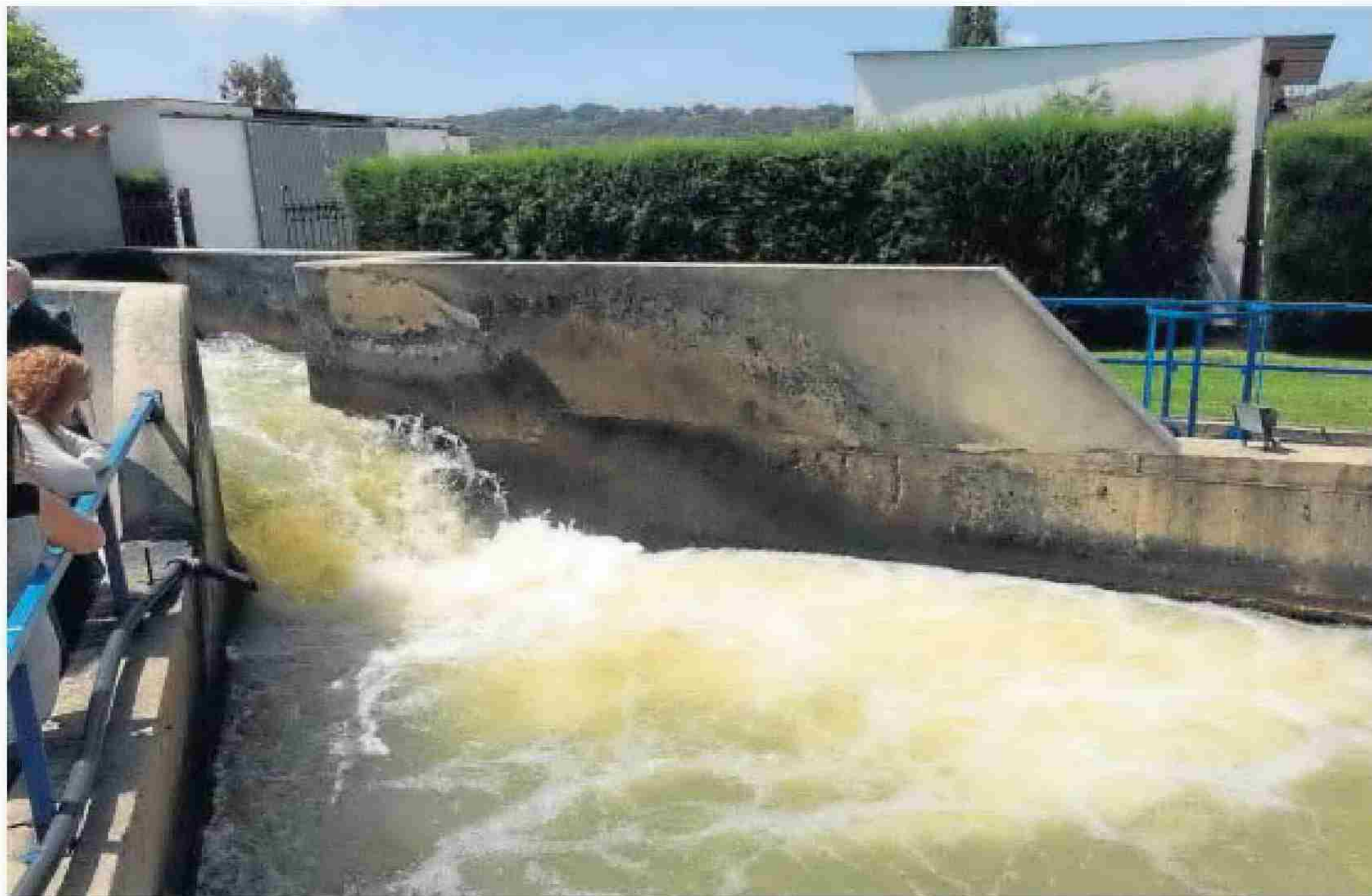
Imagen de la llegada de agua para su tratamiento a la estación potabilizadora de El Cañuelo, que gestiona Arcgisa.
