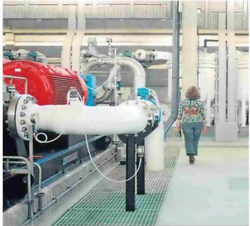
Interior de la planta desaladora de la capital.
