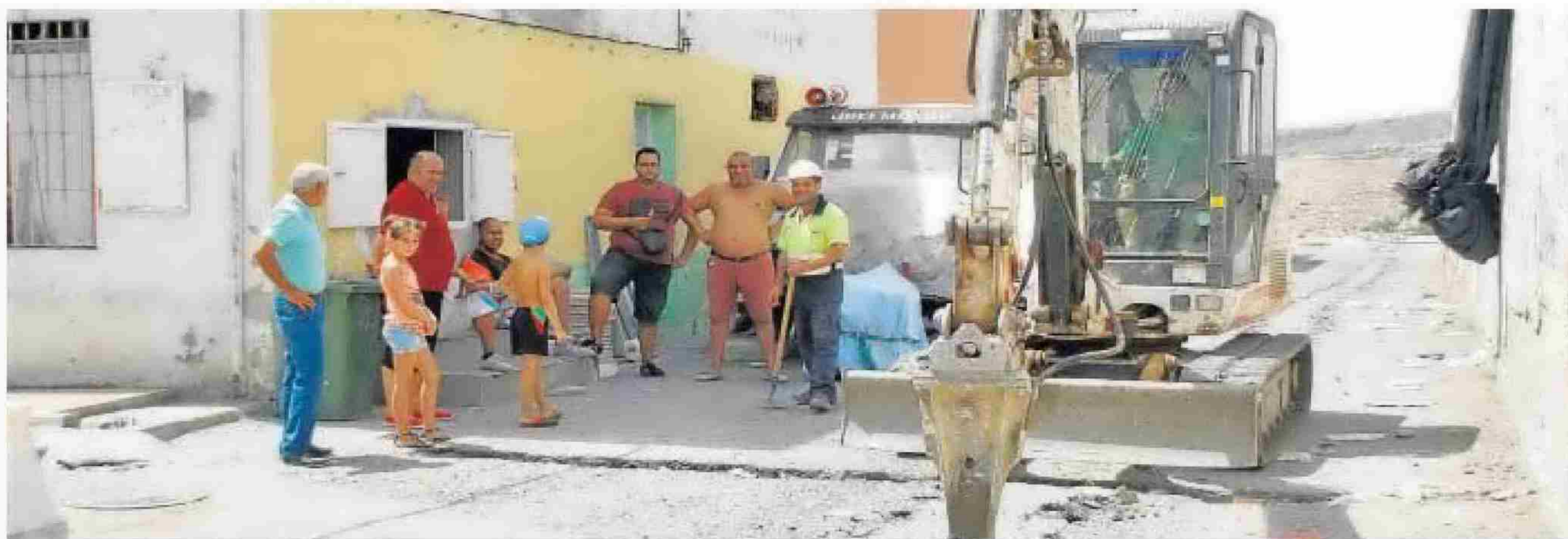
Obras de saneamiento que se llevaron a cabo para el arreglo de las tuberías.
