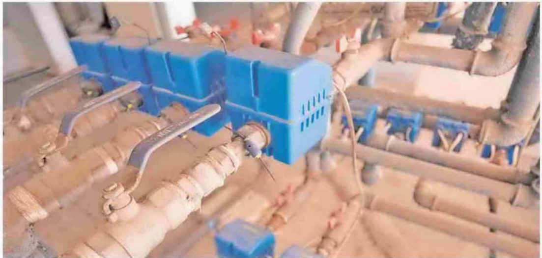
Emasa va a impulsar un plan de individualización de contadores. :: ALVARO CABRERA
