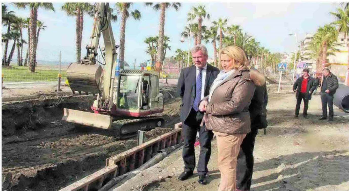
El presidente de la Mancomunidad y la alcaldesa de Almuñécar visitan las obras de Puerta del Mar. :: IDEAL
