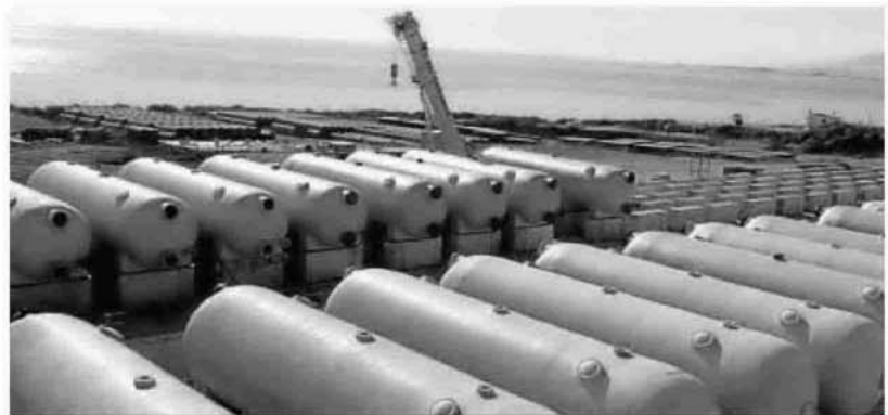
Las obras de construcción de la desaladora de El Ejido están en su última fase.
