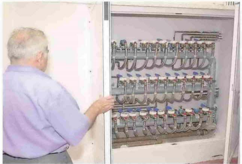
Cuadro de contadores individuales en un bloque de viviendas de Málaga. :: RÍTO SALAS
