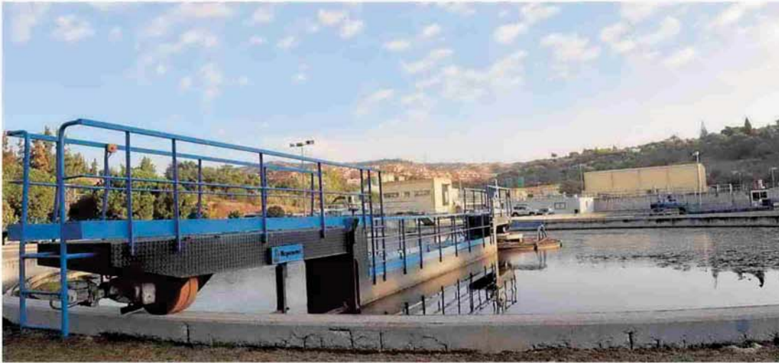
Vista de la depuradora de La Víbora. :: JOSELE-LANZA
