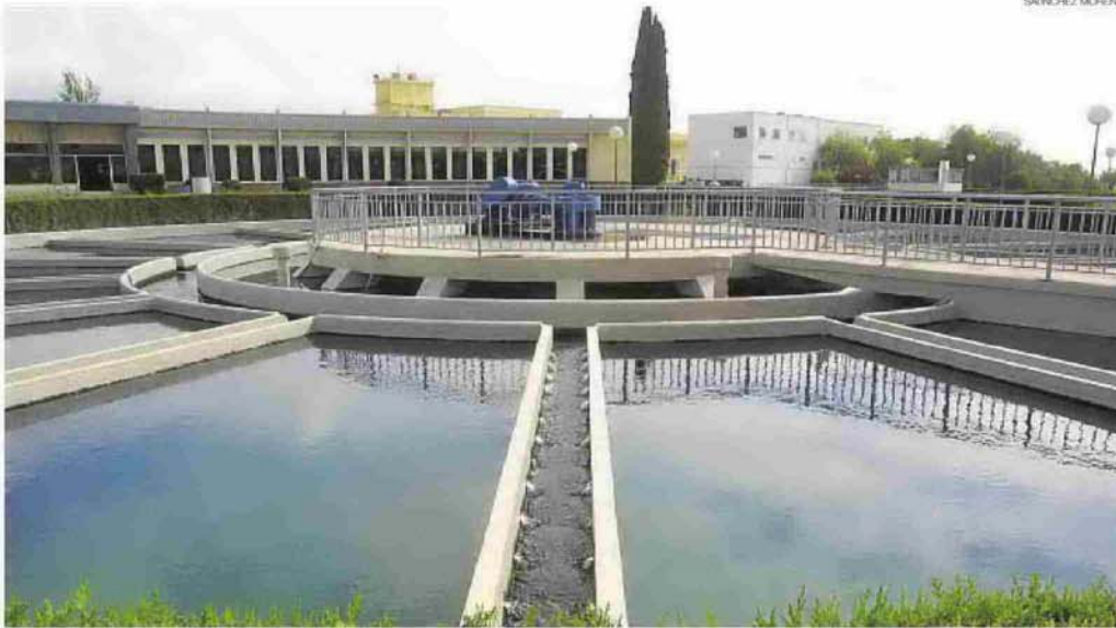
► Una vista de la estación depuradora de Villa Azul.
