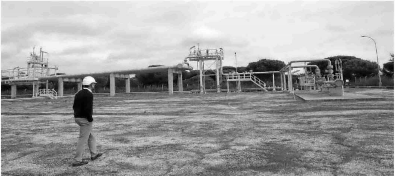
Planta de tratamiento de gas de Repsol en Mazagón.
