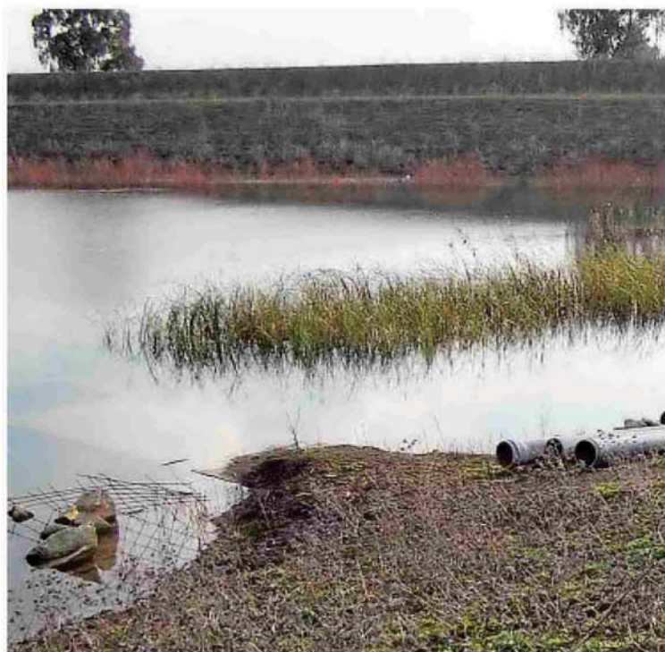
Varias tuberías tiradas en medio de una presa, y sin colocar, en la zona en la que su
