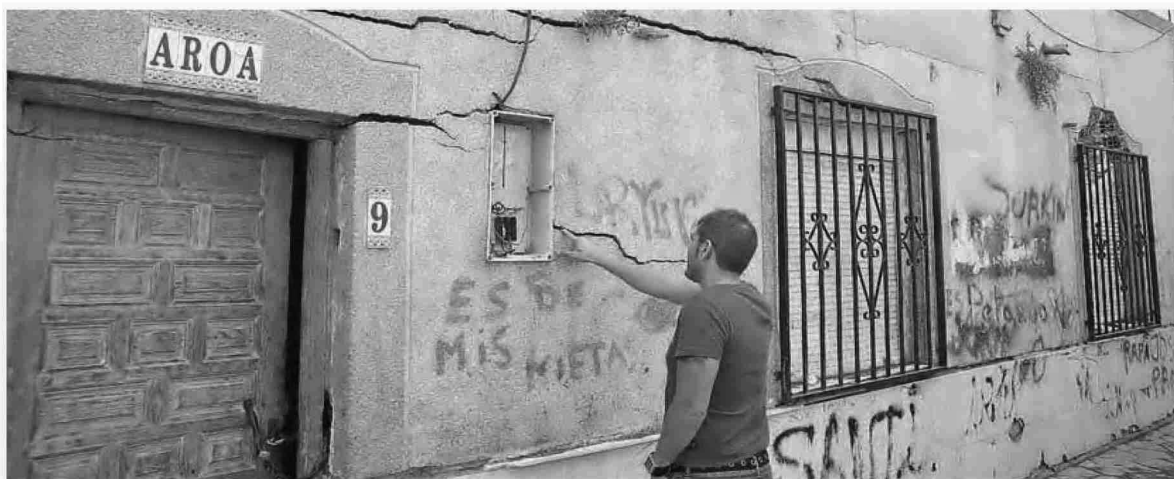
VIVIENDA dañada en la calle Resaca. LA VOZ
