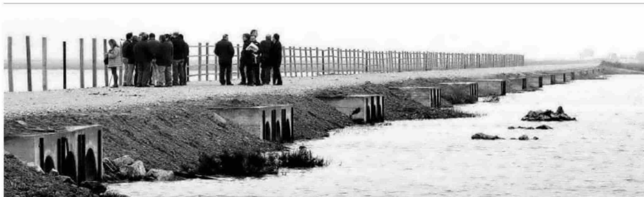
Vista general de la batería de 16 conjuntos de tres tubos que ya comunican las aguas del Guadiamar, desde el Lucio del Cangrejo Grande, con la marisma, en la zona de Entremuros. FOTOS: ALBERTO DOMÍNGUEZ
