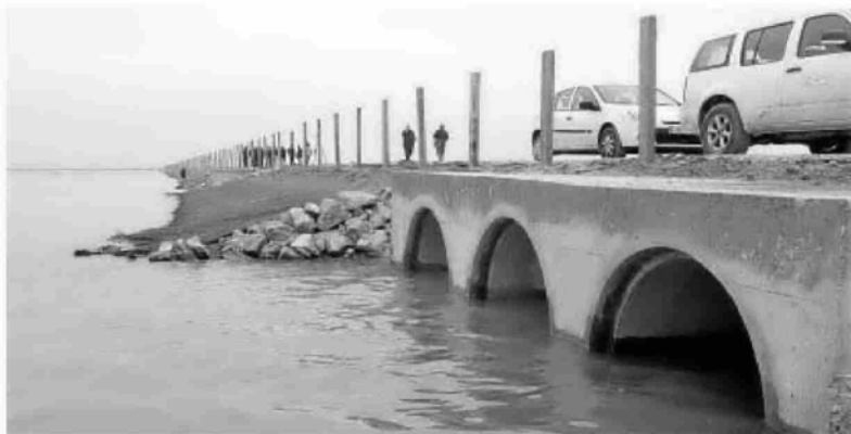
Detalle de uno de los conjuntos de tubos que aportan agua a la marisma de Caracoles, en el parque.
