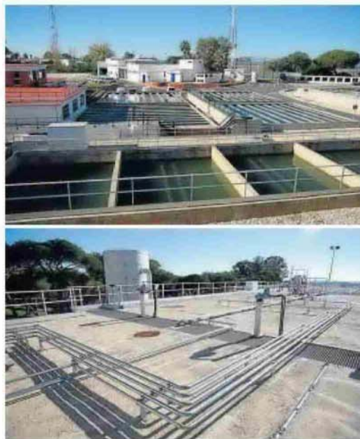
Depósitos e infraestructuras de la potabilizadora.
