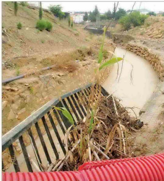
RIADA. Destrozos del agua en el cauce del arroyo, en una imagen de 2013.
