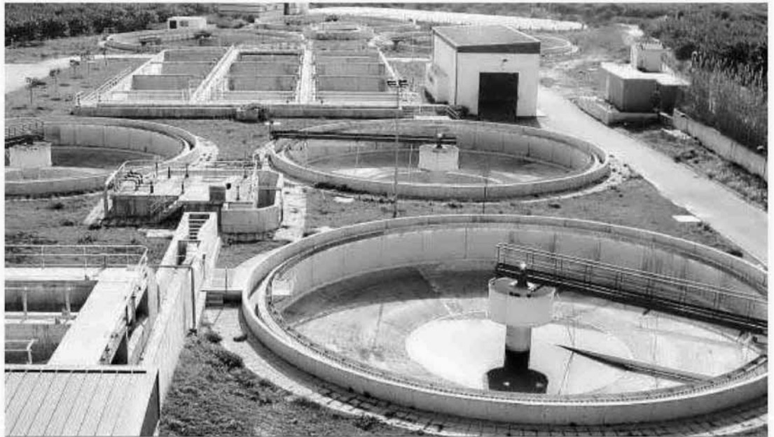
La depuradora de Almuñécar tiene una planta piloto donde se hacen las investigaciones.
