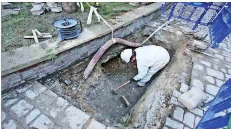
AVERÍA. Un técnico de Aqualia repara la tubería en la Plaza de los Huérfanos.
