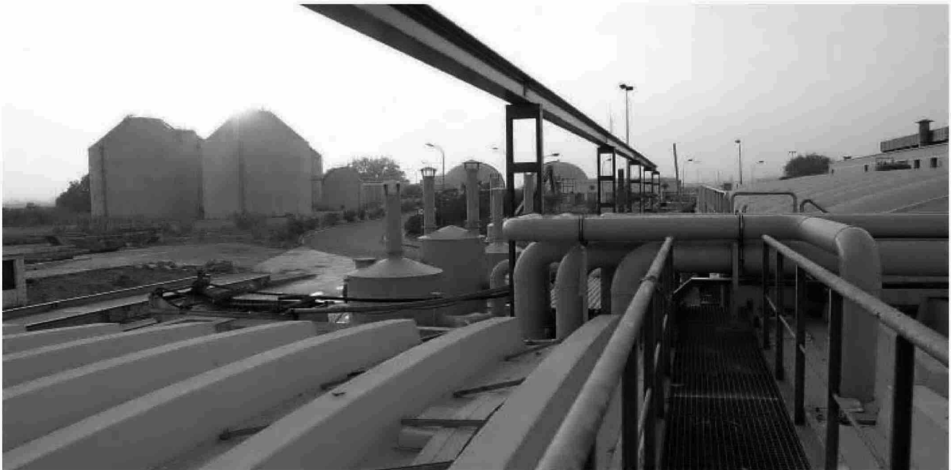
Imagen de una planta depuradora, en Málaga capital.
