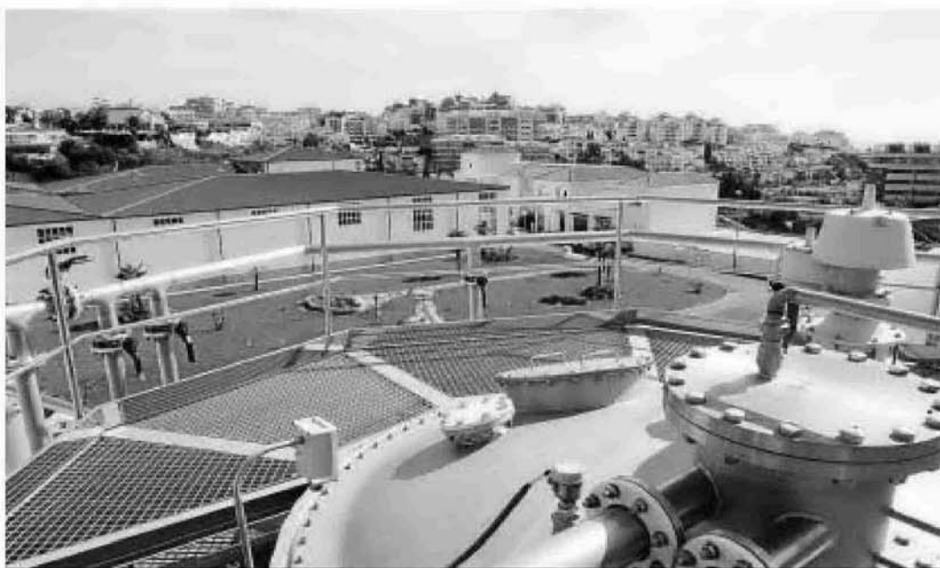
Depuradora de aguas residuales de Arroyo de la Miel.
