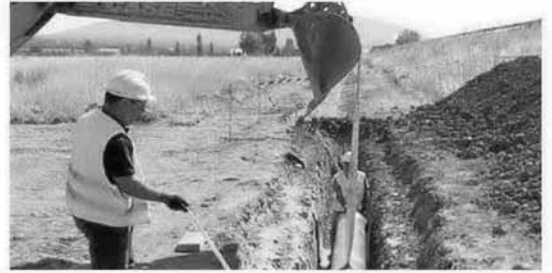
Trabajos en la red de abastecimiento del Condado. :: J. A. G. M.
